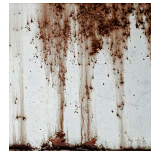
Schutz vor Rost und Korrosion
