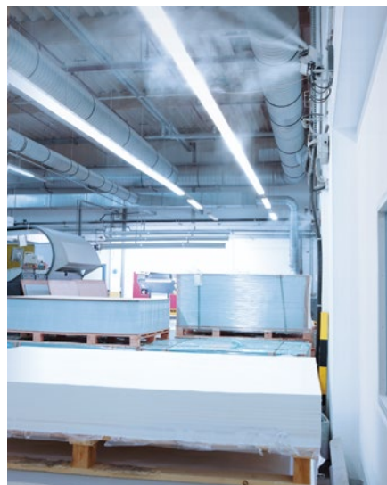
Die Luftbefeuchtung sorgt für störungsfreie Verarbeitung des Papiers
