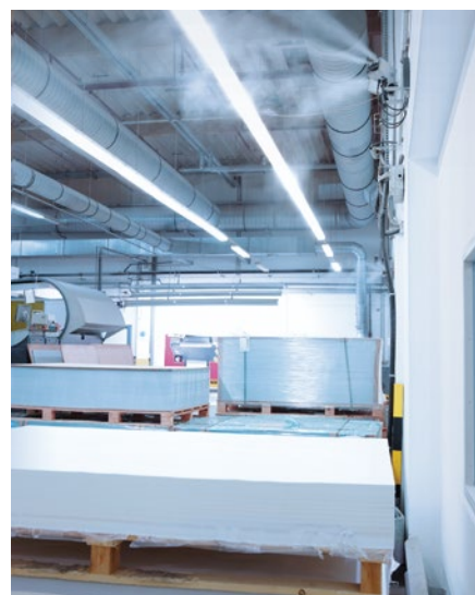
Die Luftbefeuchtung sorgt für störungsfreie Verarbeitung des Papiers
